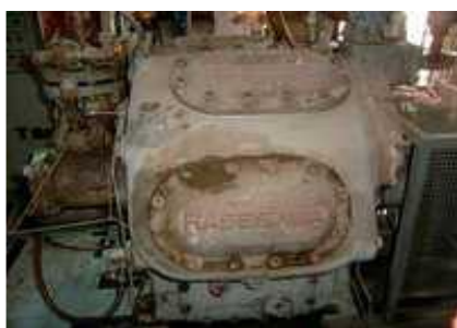
รูปที่ 6.13-1 เครื่องอัดสารทำความเย็นชุดที่จะเปลี่ยน
