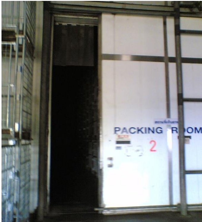
รูปที่ 6.15-2 ห้องเย็น
