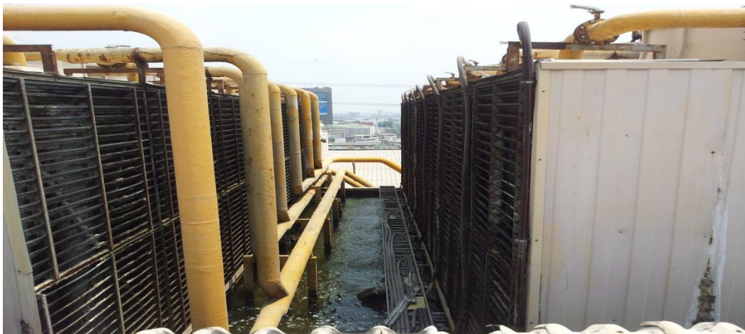
รูปที่ 5.11-40 บ่อน้ำออกจากหอรบายความร้อน
