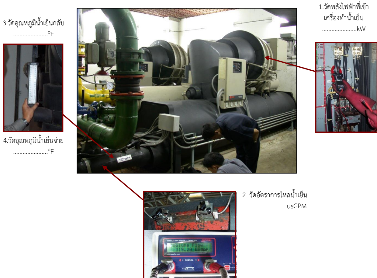
รูปที่ 5.6-1 การตรวจวัดสมรรถนะเครื่องทำน้ำเย็น
