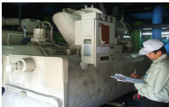
รูปที่ 5.11-16 Chiller No.4
