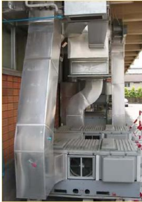
รูปที่ 5-1 ระบบลดความชื้นด้วยสารดูดความชื้นเหลวที่ติดตั้งในโรงงานผลิตยา (4)
