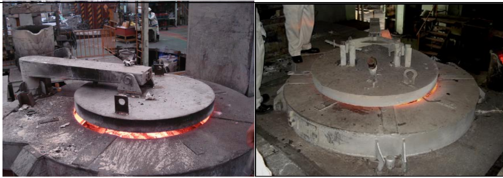
รูปที่ 3.8-16 สภาพการใช้งานเตาหลอม (หลังปรับปรุง)
