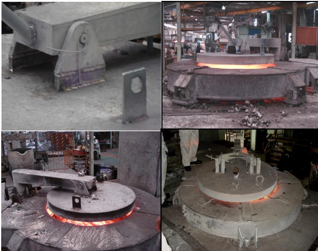
รูปที่ 3.8-16 สภาพการใช้งานเตาหลอม (หลังปรับปรุง)
