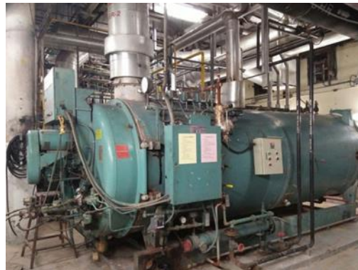
รูปที่ 2.12-23 หม้อไอน้ำที่ลดเวลาการใช้งาน
