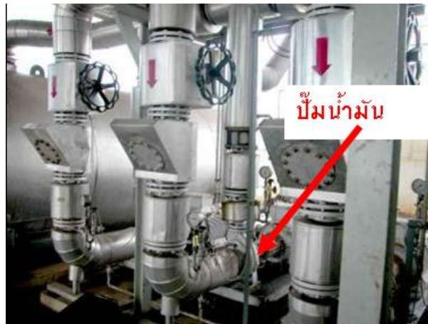
รูปที่ 2.12-27 ปั๊มน้ำมันร้อนก่อนปรับปรุง
