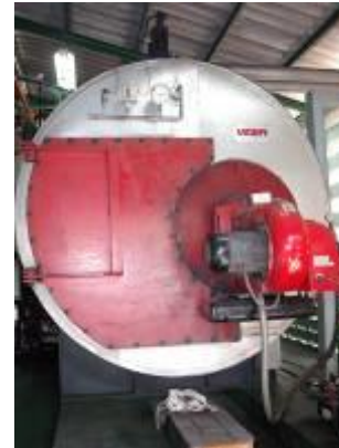
รูปที่ 2.12-14 หม้อไอน้ำขนาด 4.5 ตัน
