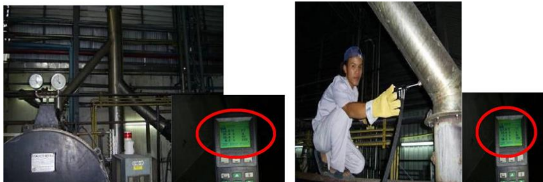
รูปที่ 2.12-26 การตรวจวัดประสิทธิภาพหม้อไอน้ำก่อน-หลังปรับปรุง
