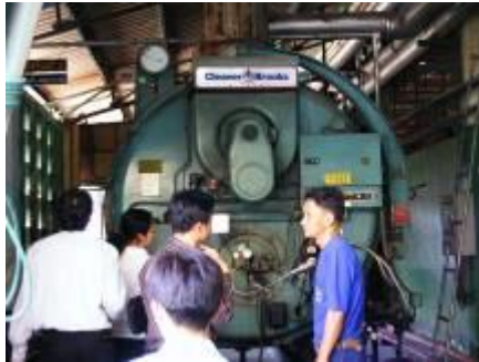
รูปที่ 2.12-13 หม้อไอน้ำขนาด 4.5 ตัน
