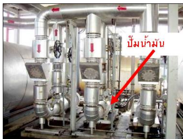
รูปที่ 2.12-28 ปั๊มน้ำมันร้อนหลังปรับปรุง
