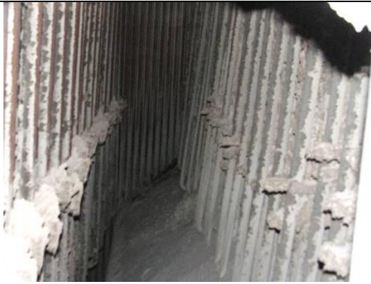
รูปที่ 2.12-5 ตะแกรงที่จับที่ท่อไอน้ำก่อนทำความสะอาด
