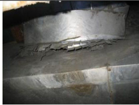
รูปที่ 2.12-6 รอยรั่วของหม้อไอน้ำก่อนปรับปรุง
