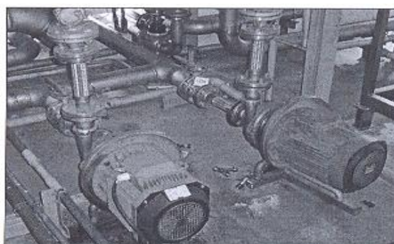
รูปที่ 6.12-14 แสดงเครื่องสูบน้ำที่ใช้ในการส่งจ่ายระบบน้ำ RO ให้กับเครื่องจักรในกระบวนการผลิต
