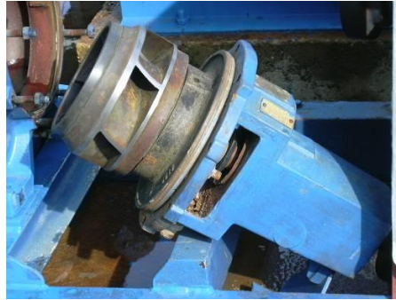
รูปที่ 6.12-12 แสดงใบพัดเครื่องสูบน้ำขนาด 18.5 ซม หลังปรับปรุง
