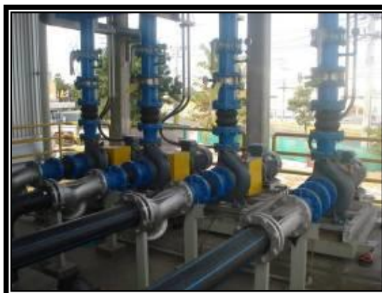
รูปที่ 6.11-19 มอเตอร์เครื่องสูบน้ำ
