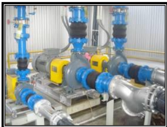
รูปที่ 6.11-18 มอเตอร์หอรบายความร้อน
