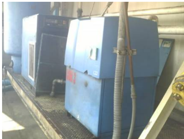
รูปที่ 5.10-13 การใช้เครื่องอัดอากาศภายในโรงงาน
