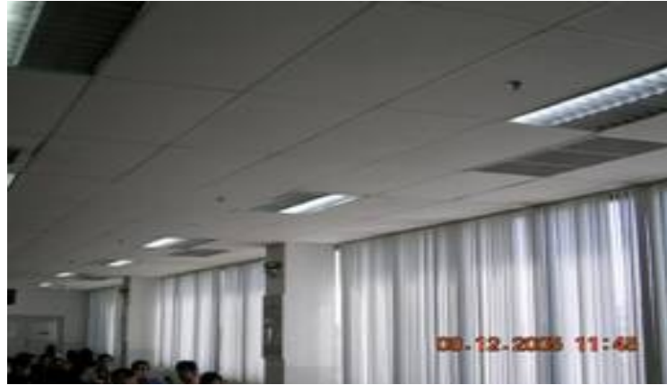
รูปที่ 3.14-4 เปิดไฟฟ้าแสงสว่างในขณะที่มีแสงสว่างจากภายนอก
