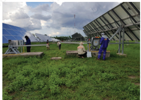
THAILAND : Solar Farm EGCO SPP5 ร้อยเอ็ด
