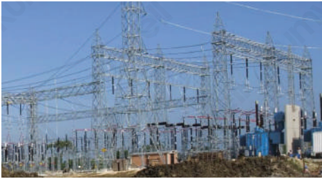
COLOMBIA : CENTRAL 20MW EPM-EPC SE MALENA SUBSTATION 230 KV
