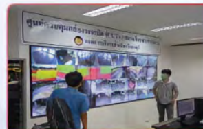
ห้องควบคุมห้องวงจรปิด
