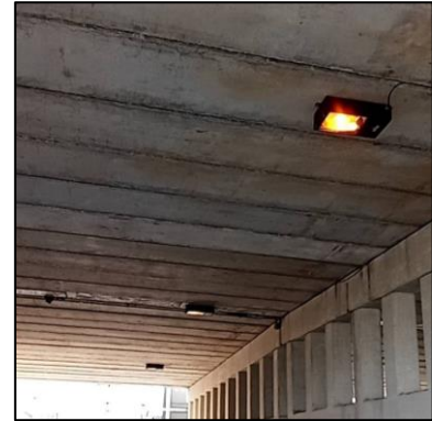
โคมติดใต้สะพาน
