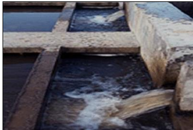
บ่อให้อากาศ1+น้ำจุลินทรีย์
