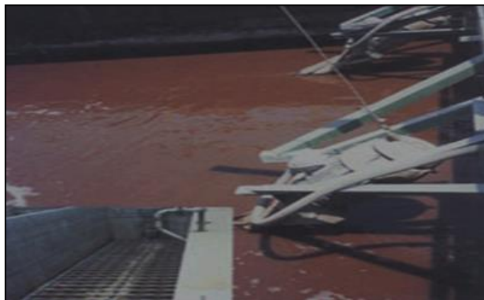
บ่อน้ำเสียที่มีตะกอน+น้ำจุลินทรีย์
