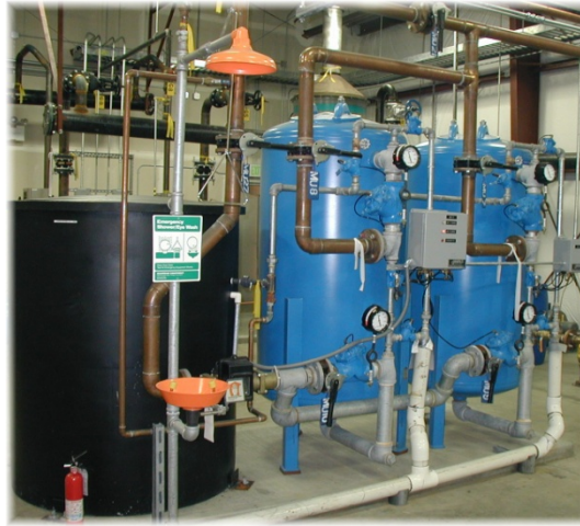
รูปที่ 5-2 ถังกรองน้ำอ่อน
