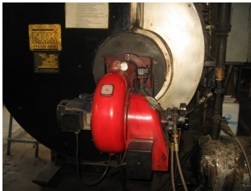
รูปที่ 6-20 หม้อน้ำที่ใช้ในโรงงาน
