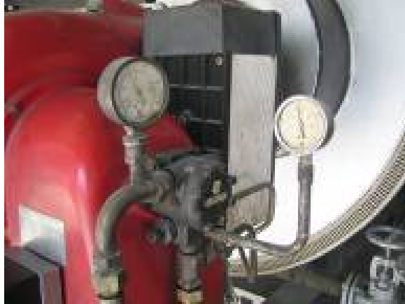
รูปที่ 6-8 ระบบหัวฉีดน้ำมันเตา
