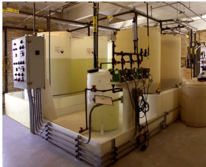
รูปที่ 5-13 ระบบเติมเคมี
