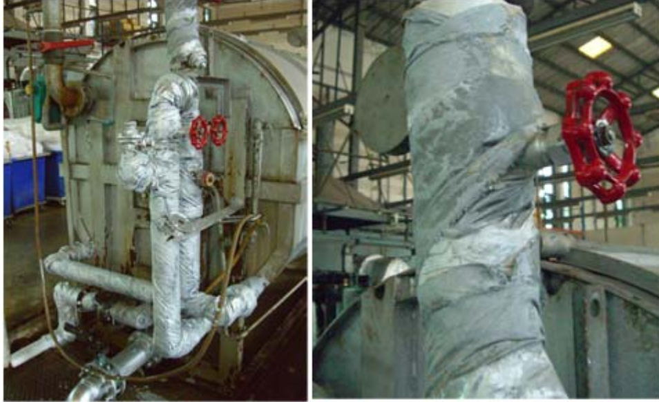
รูปที่ 6-14 ท่อไอน้ำได้รับการหุ้มฉนวนหลังทำการปรับปรุง
