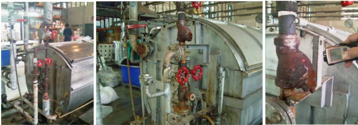
รูปที่ 6-13 ท่อไอน้ำที่ไม่มีการหุ้มฉนวน
