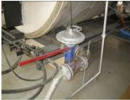
รูปที่ 6-6 Intermittent Blow down Valve
