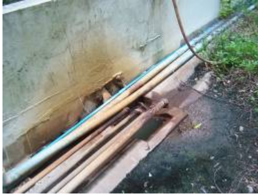
รูปที่ 6-12 การปล่อยทิ้งไอน้ำหลังการปรับปรุง
