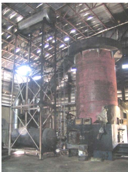
รูปที่ 6-26 บริเวณเกิดอุบัติเหตุไฟไหม้
