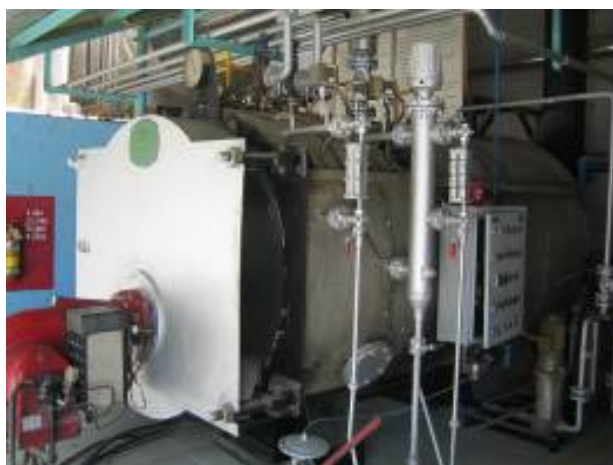
รูปที่ 7-4 หม้อน้ำเครื่องที่ 1 ขนาด 1,725 kg/hr
