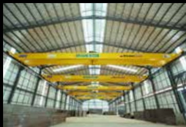
เครนไฟฟ้าเหนือศีรษะ แบบคานคู่ Overhead Crane : Double Girder
