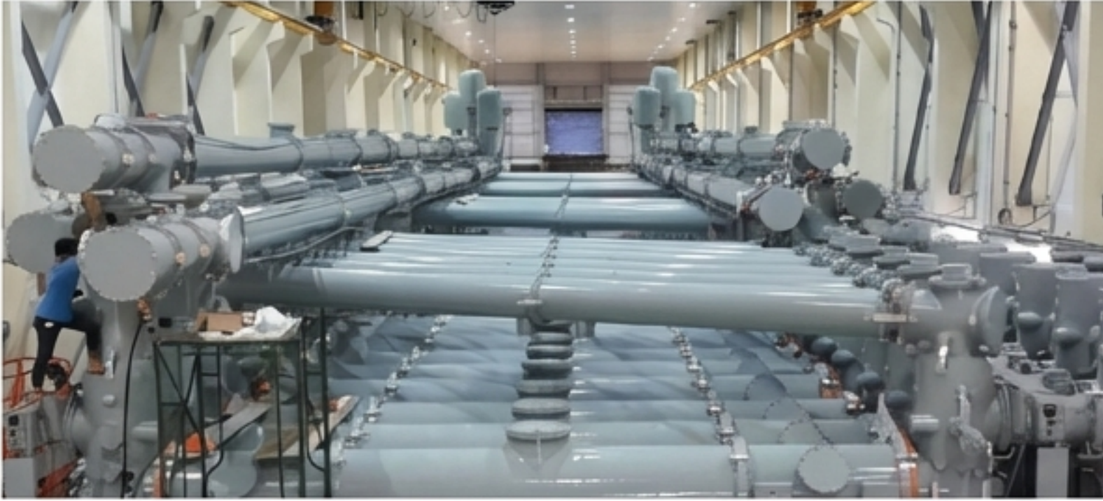
500kV GIS Substation - EGAT Wangnoi
