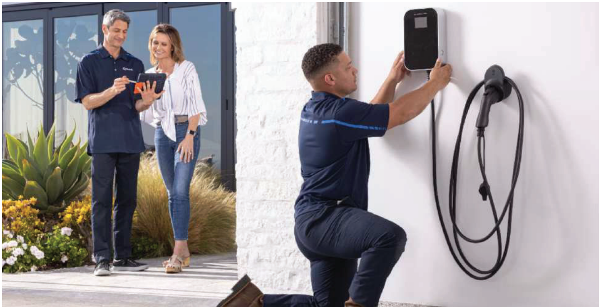
ภาพที่ 1 การติดตั้งใช้งาน EV Charger ในบ้าน
