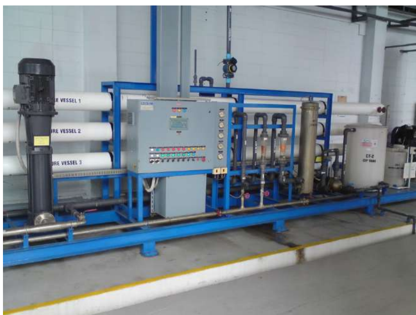
รูปที่ 6.3 ระบบผลิตน้ำบริสุทธิ์แบบ Reverse Osmosis (RO)
