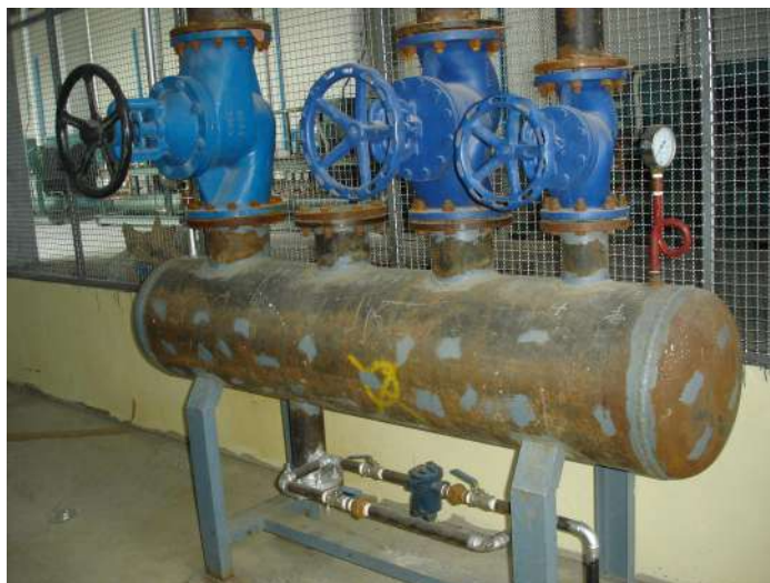
รูปที่ 1.9 ถึงพักไอน้ำก่อนการหุ้มฉนวน
