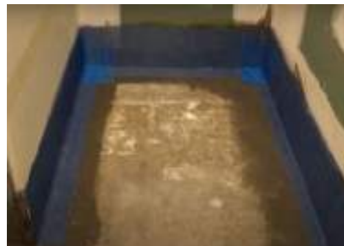
5. ติดตั้งเทปตาข่าย RHINOZ ไฟเบอร์กลาส ตามแนวรอยต่อพื้น-ผนัง และรอบท่อ
