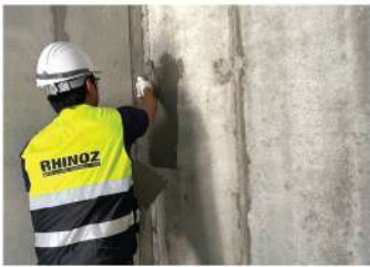
1. ฉาบแต่งผิวผนัง ด้วยซีเมนต์ฉาบปรับระดับเสริมแรง สูตร Biobase ฉาบหนา 6 mm.
