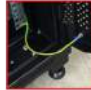
ตู้ มีระบบ GROUNDING
