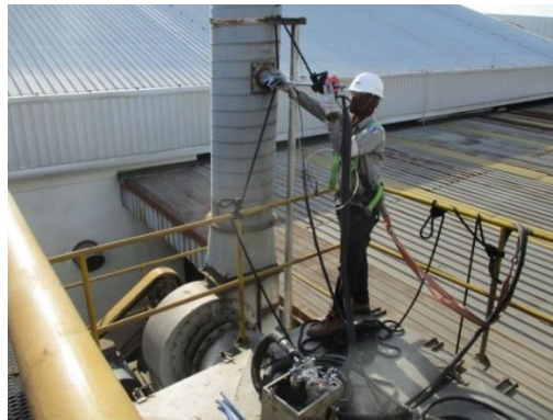
ตรวจวัดอากาศในปล่องระบาย
