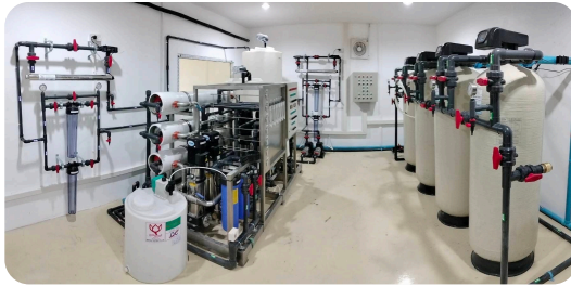
ตัวอย่างการติดตั้งระบบผลิตน้ำ RO
